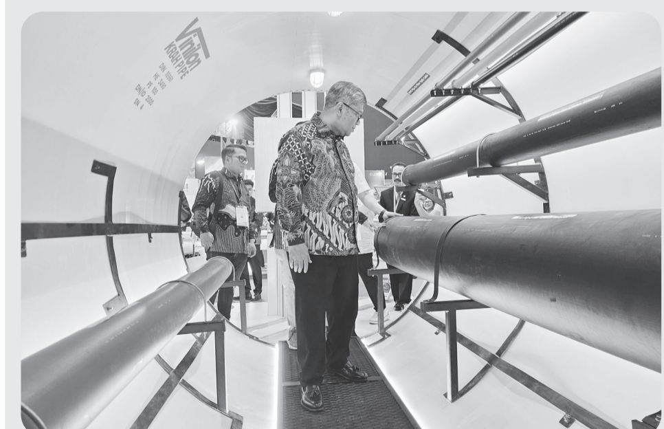
Ade Palguna selaku Deputy Bidang Pengelolaan Sampah, Limbah dan Bahan Berbahaya dan Beracun KLH/BPLH saat berkunjung ke Multi Utility Tunnel Pipa Vinilon KRAH.
